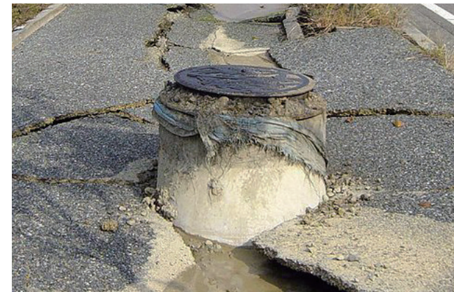
▲液状化現象で浮き上がったマンホール
